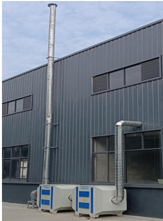
危废库二级活性炭+排气筒
