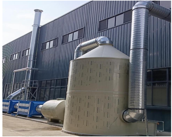
水喷淋塔+二级活性炭吸附装置+排气筒 DA004
