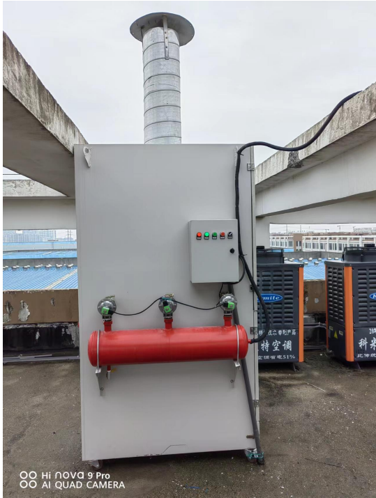
烟尘净化器+排气筒 DA002
